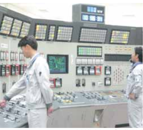
●中央制御室内でのポンプ起動操作
